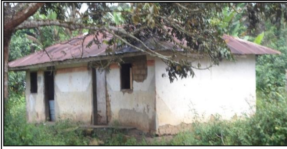
Photo n°8: Vue d'une maison en ruine d'un planteur de tabac et de café à Kébara (Plateaux) (Cliché de P.H.NDEY NGANDZO ,2013)
