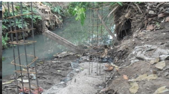
Photo 4 : vue d'une habitation en construction sur un cours d'eau à Mpaka contre-rails.
