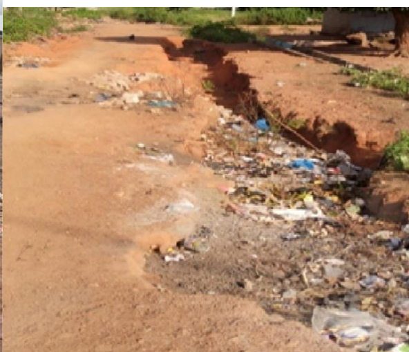
Photo 2 : le ruissellement exerce une érosion sur des altérites meubles sur croupes gravillonnaires à Korhogo
